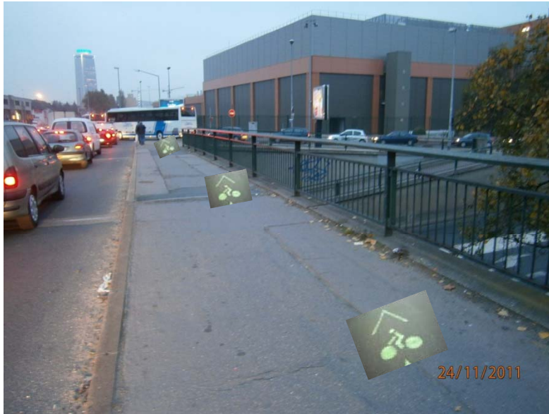
Sur le pont au dessus D24 (Rue A Croizat) Marquage Piste Rénovation revêtement (2 ème temps)
